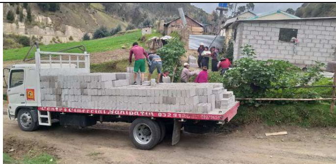
A metà dicembre abbiamo iniziato a consegnare i materiali anche per la costruzione di 20 bagni familiari nella comunità di Lupaxi Bajo, Canton Colta.
